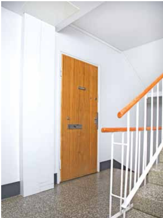
Element för el- och vattenledningar intill varandra.
